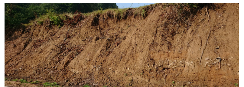
Abspülung Böschungskante im Übergang Grünland - Straße
