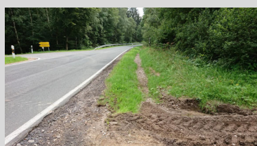
Abb. 4: Verspülung Wegebauaterial in Straßengraben beim Übertritt Schotterweg auf Landstraße (L: 376 m; H: 510 m)
