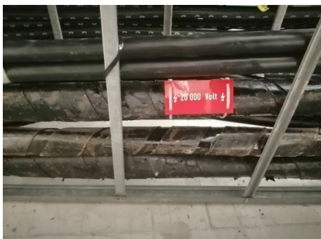
Starkstromleitungen mit brüchigen Bitumenummantelungen. Quelle: Rechnungshof Rheinland-Pfalz.
