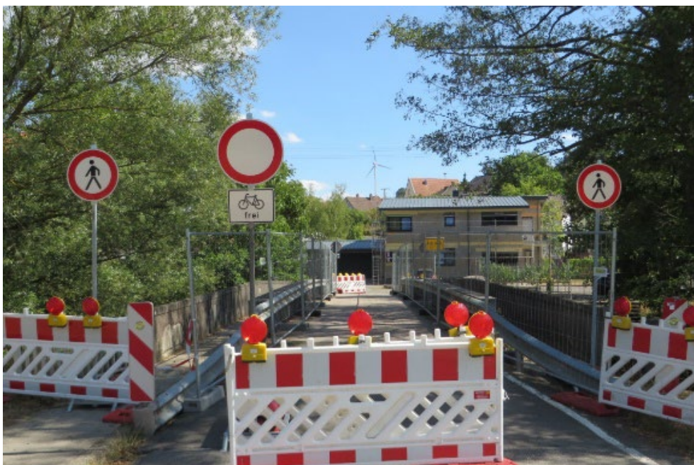
Sperrung Glanbrücke im Landkreis Kusel. Quelle: Rechnungshof Rheinland-Pfalz.
