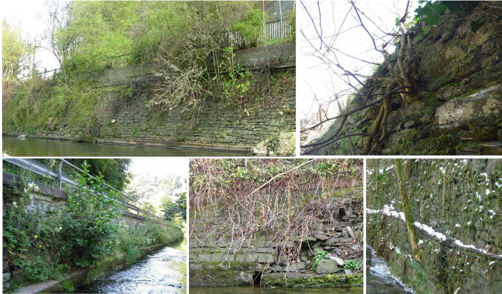
Schäden durch Bewuchs als Folge einer nachlässigen Unterhaltungstätigkeit.
