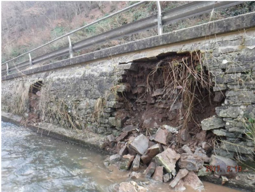
Teileinstürze eines Stützbauwerks unmittelbar am Fahrbahnrand der Landesstraße 4 infolge einer über zehn Jahre nachlässigen Unterhaltungstätigkeit und nicht ordnungsgemäßer Bauwerkskontrollen.
