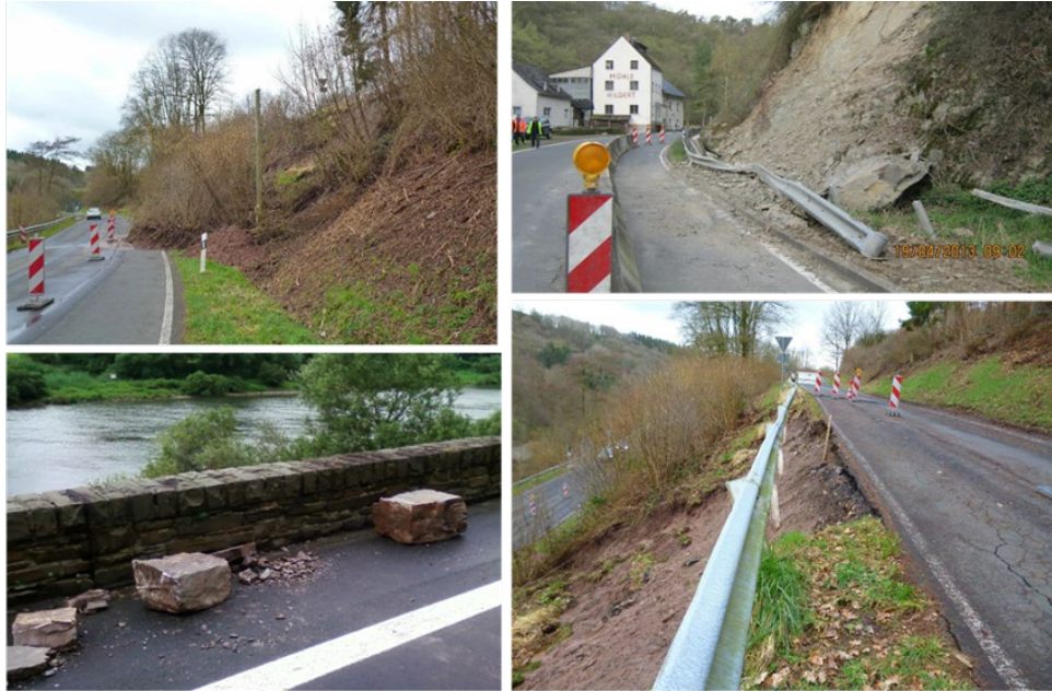
Verkehrsgefährdungen, -eingriffe und Schäden durch Rutschungen und Steinschlag in Rheinland-Pfalz (Fotos des Landesbetriebs Mobilität)
